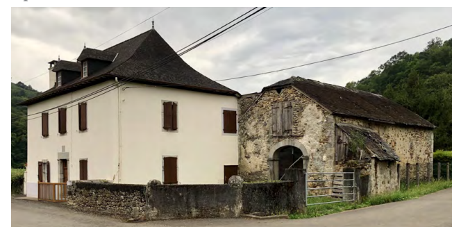
Avant travaux. Un bâtiment agricole très dégradé.
