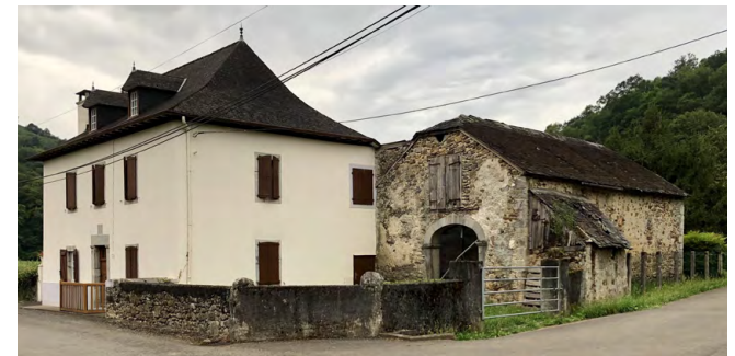
Avant travaux. Un bâtiment agricole très dégradé.
